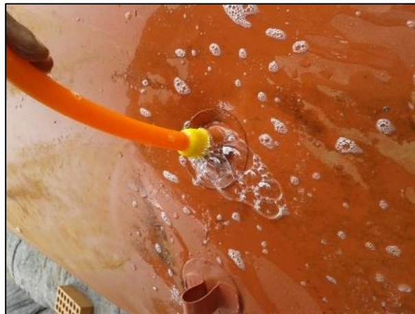
Figura 05. Um dos Pontos de Fuga de Biogás Identificados no Biodigestor.
